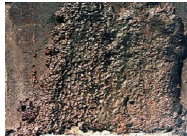
Рис.1 Разрушение углеродистой стали верхней части нефтепровода под действием сероводородной коррозии (12-часовая коррозия).
